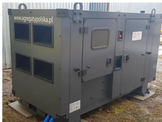
Fot. Agregat prądotwórczy wraz z układem SZR zamontowany na stacji uzdatniania wody w Kamieniu Krajeńskim
