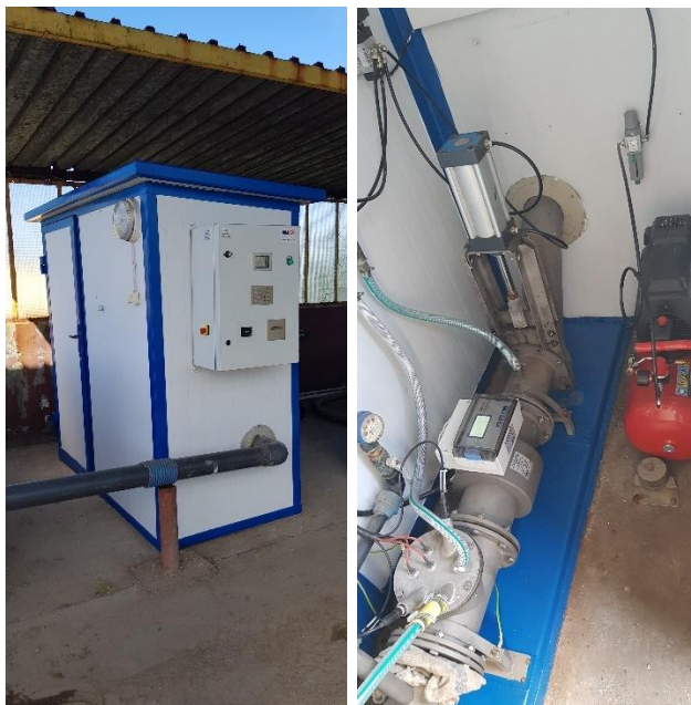
Stacja zlewna na oczyszczalni ścieków w Kamieniu Krajeńskim
